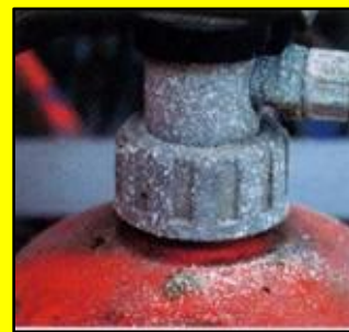
層状のはく離
