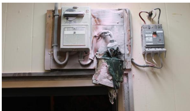
管内で発生した低圧進相コンデンサの火災
